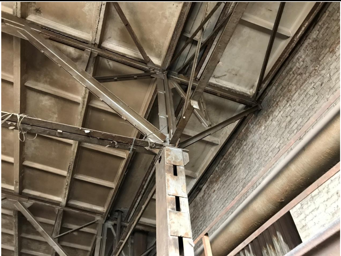
Фото 11. Узел опирания фермы на конструкцию колонны по оси Д. Сборные железобетонные ребристые плиты покрытия
