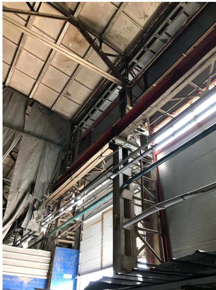
Фото 12. Общий вид колонны по оси А. Узел опирания подкрановой балки на колонну каркаса
