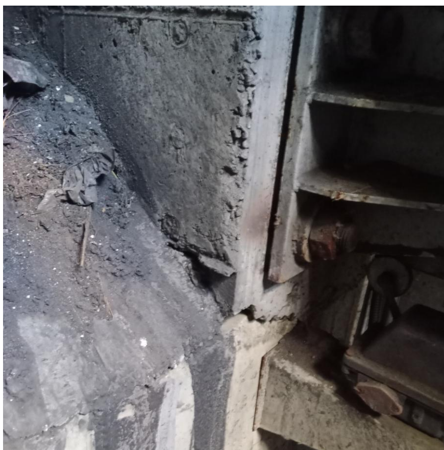
Рис. 3.9 Непролив в фундаменте
