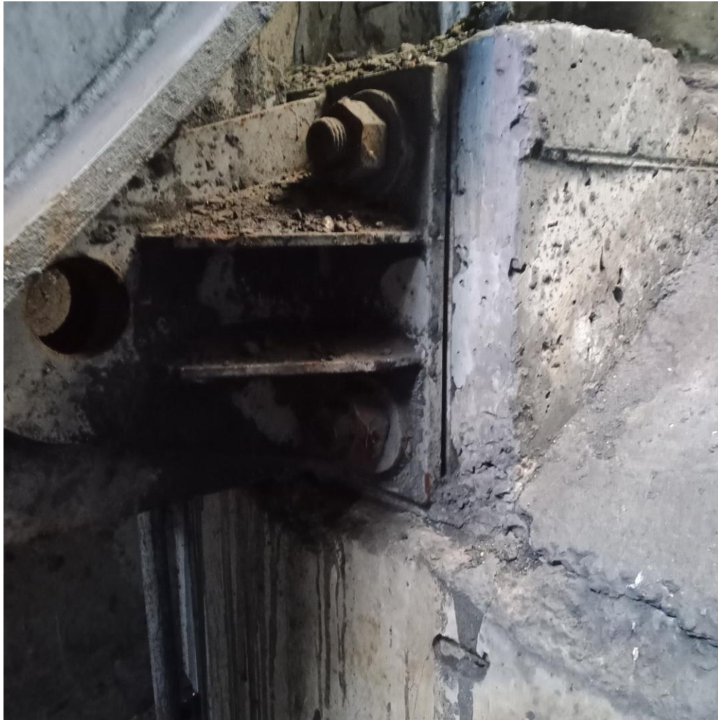
Рис. 3.10 Фундамент в месте упора с левой стороны.
