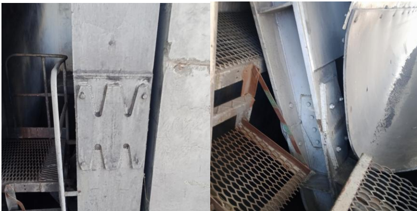
Рис. 3.3 Сварные швы опор крайних и средних - лекальные рельсы в удовлетворительном состоянии, износ не критичный (5 – 6 мм)
