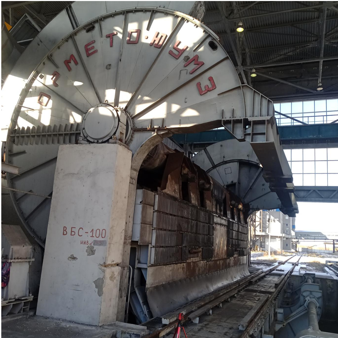
Рис. 3.1 Общее состояние металлоконструкций вагоноопрокидывателя ВБС 100.
