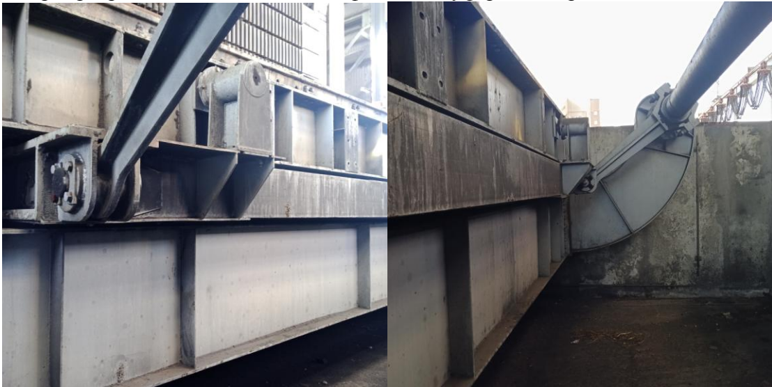
Рис. 3.5 Состояние шарниров и буферов
