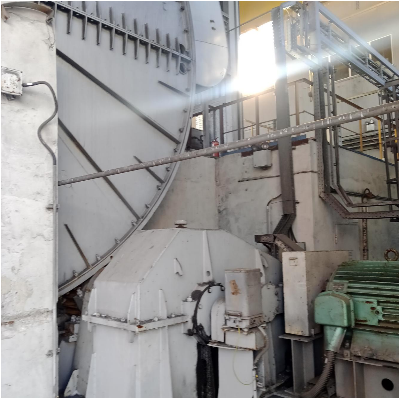
Рис. 3.7 Состояние приводов опрокидывания
