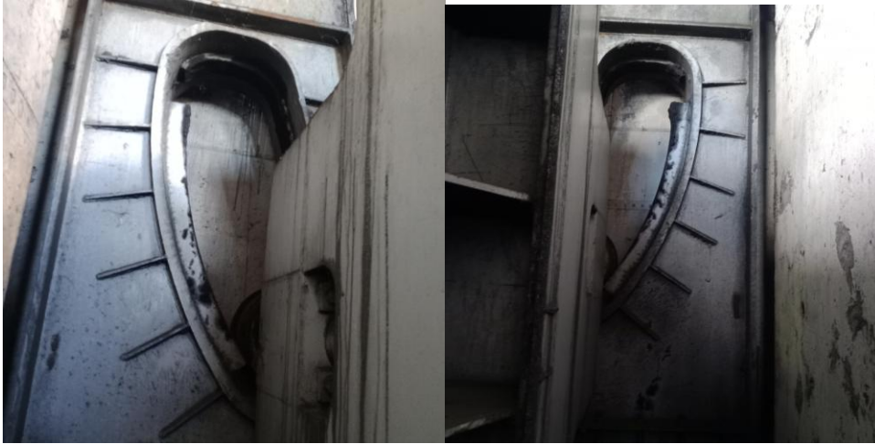
Рис. 3.4 Состояние лекальных рельсов
