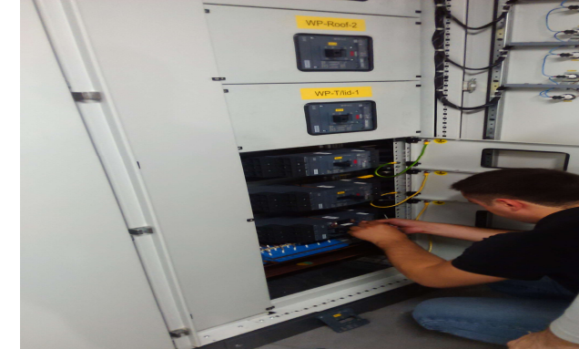
Расположение автоматических выключателей на ГРЩ (ТП-3.2 и ТП-4 ГРЩ-3). Для испытаний их необходимо демонтировать с посадочной корзины
