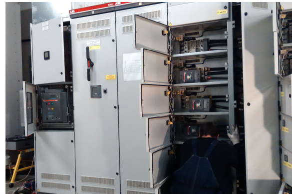
Расположение автоматических выключателей на ГРЩ. Для испытаний их необходимо демонтировать с посадочной корзины
